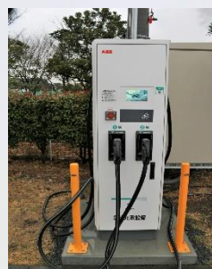
急速充電設備
